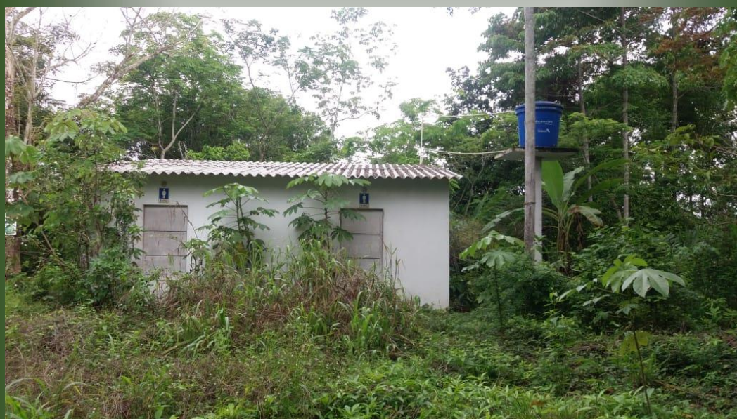
Foto Predio San Ignacio. Batería de baños sin uso
