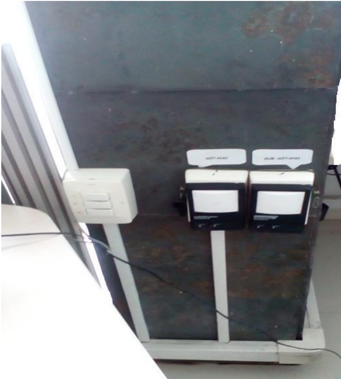
FOTO N°45 RAMPLAS DE ACCESO SISTEMA DE SEGURIDAD Y ALARMAS
