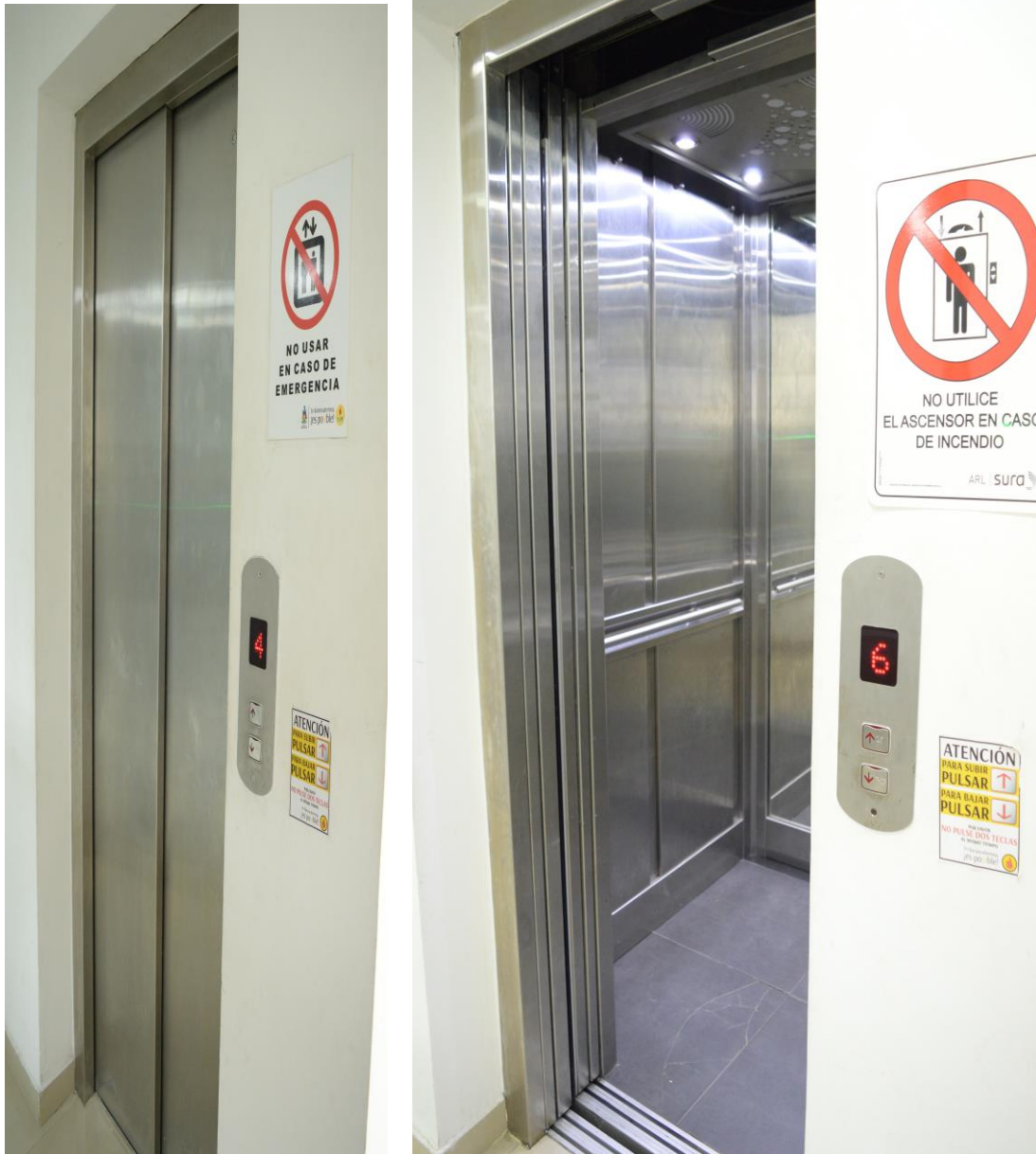
FOTO N°43 ASCENSORES EDIFICIO INTELIGENTE Calle 71 No 27.08
